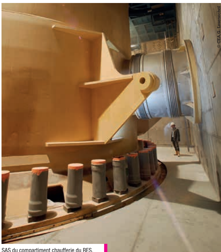
SAS du compartiment chaufferie du RES.
