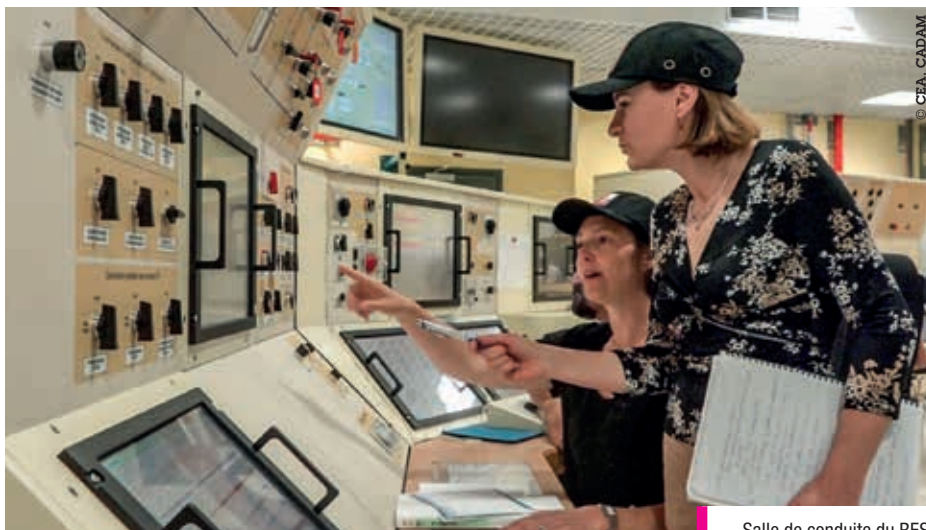
Salle de conduite du RES.
