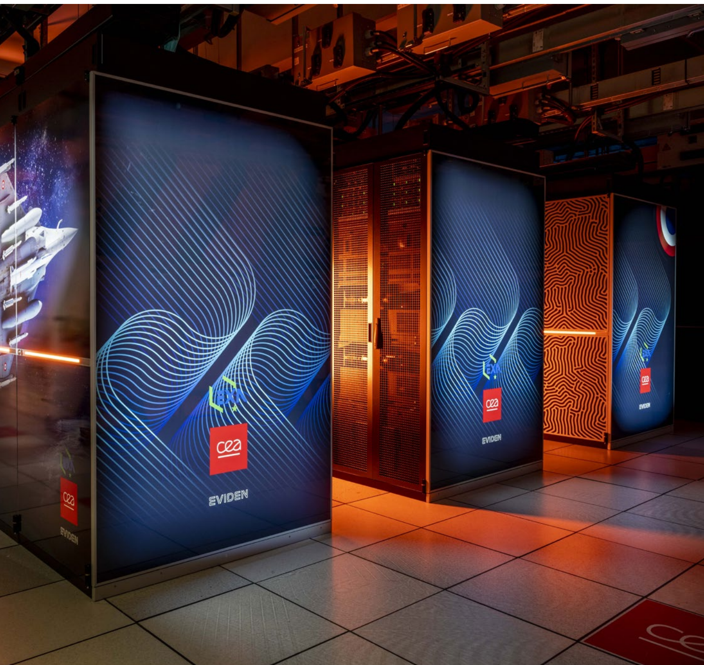
↑ Machine EXA1-HE, mise en service en 2024 sur le centre CEA/DAM Ile-de-France (DIF)
